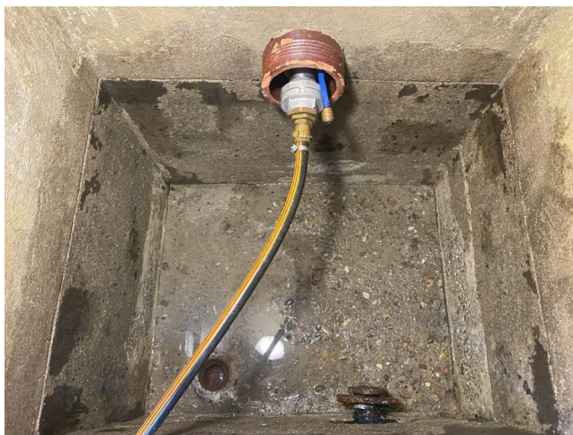
Degradovaný povrch usazovací jímky
